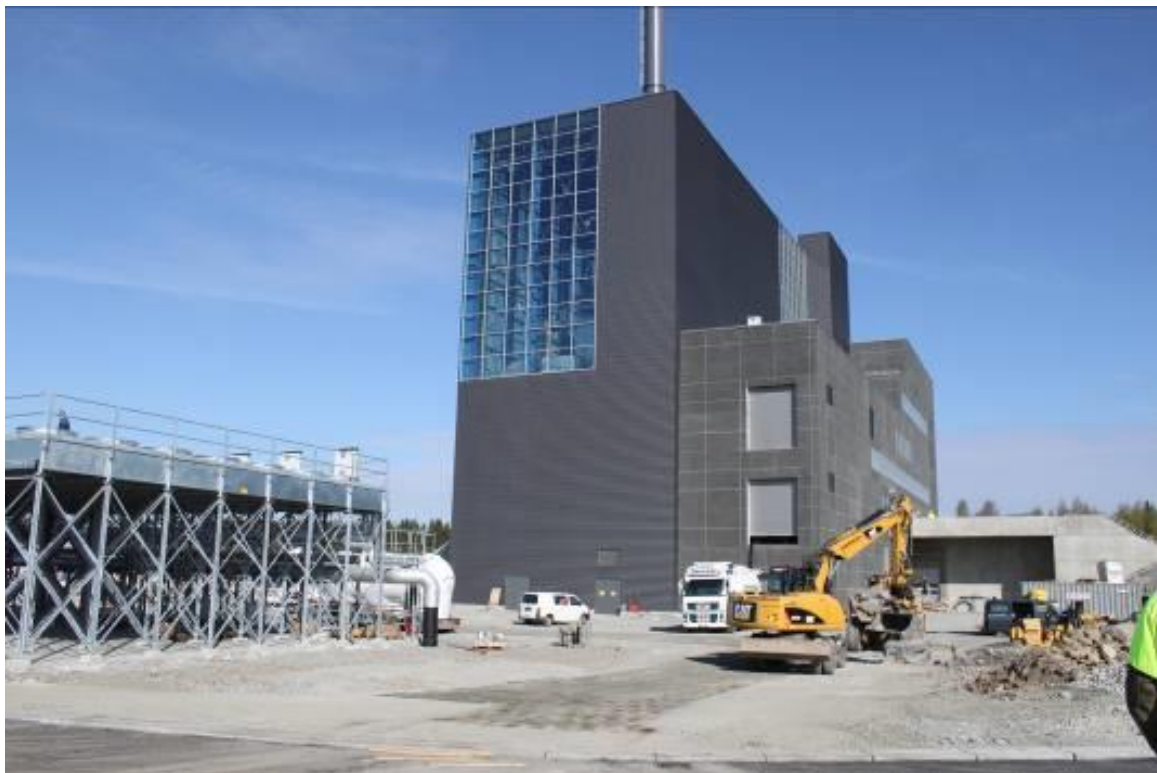
Fra deponering til energiutnyttelse av restavfallet. Det nye forbrenningsanlegget i Trehørningen.
